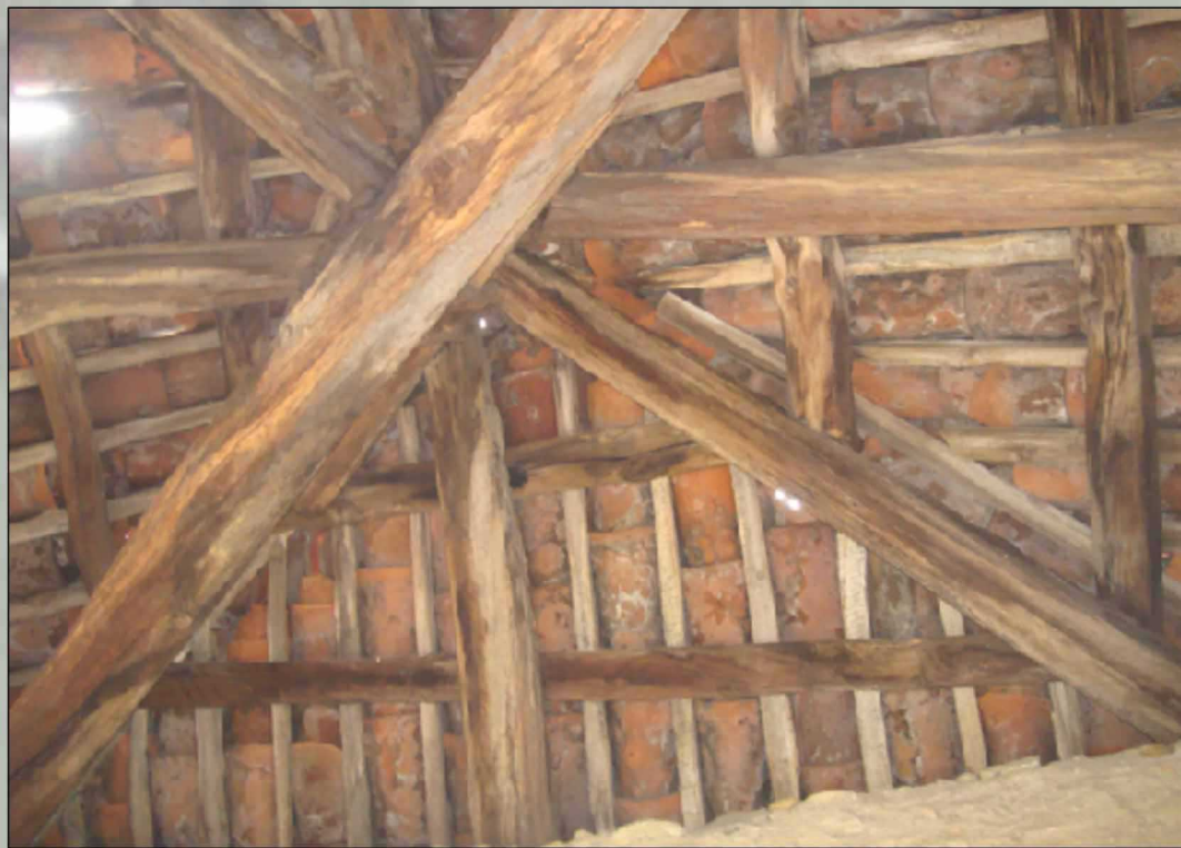
Piccola e grossa orditura fortemente ammalorata.
