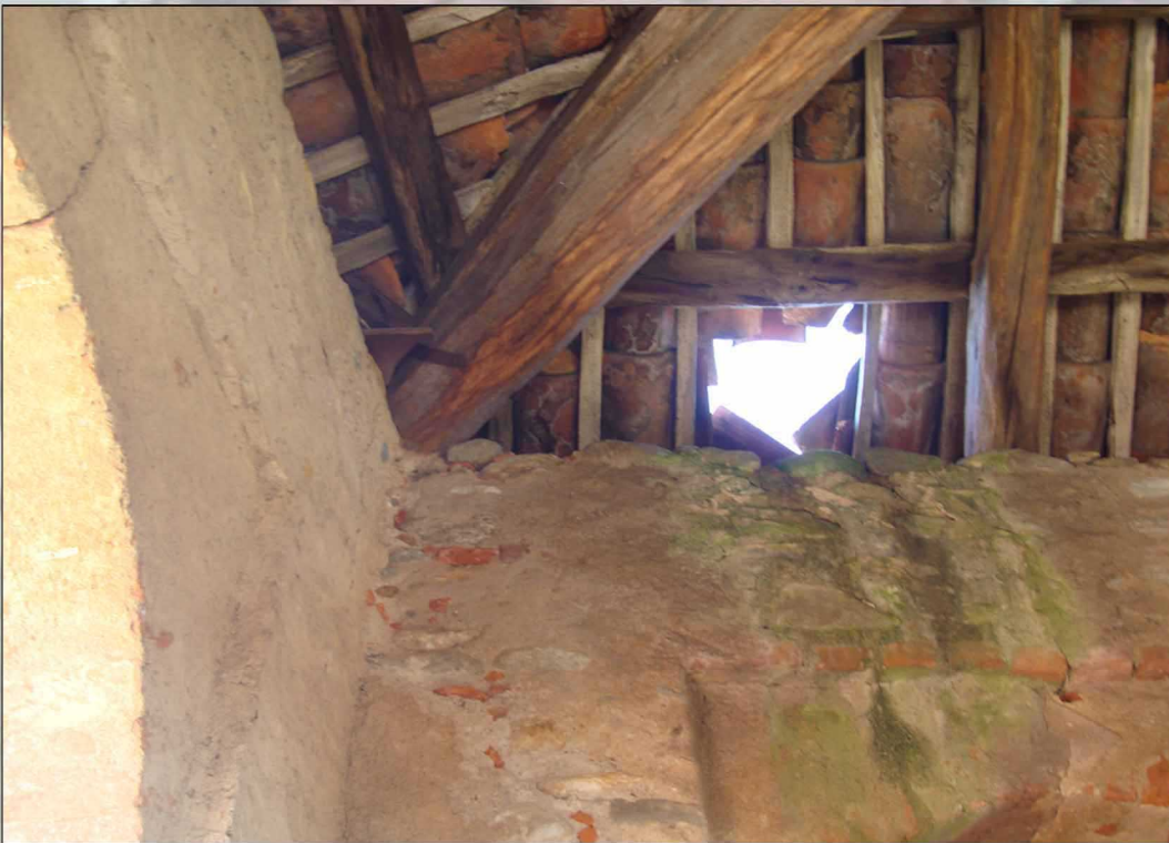
La caduta di una porzione del manto di copertura genera il dilavamento della malta della muratura interna
