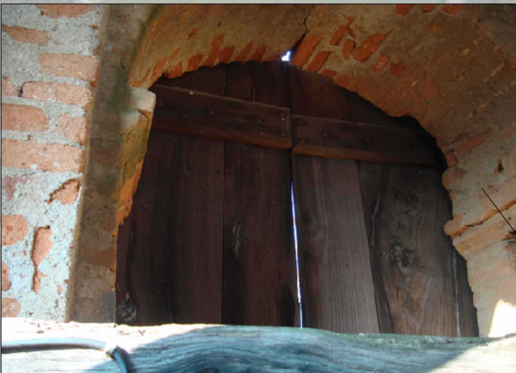
Volta compromessa dall'appoggio del puntone
